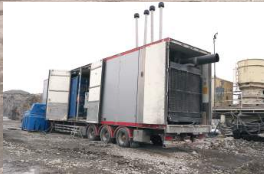
Murskauslaitoksen polttoainehuolto hoituu 16 500 litraisella konttisäiliöllä, mikä on sijoitettu puoliperävaunun sisään yhdessä generaattorin kanssa.
