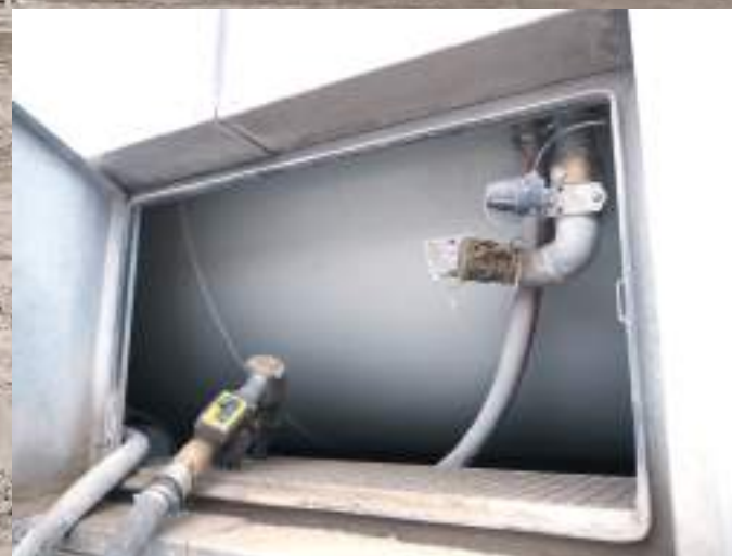
Kyljessä on polttoainepumppu (200 l/min) millä voidaan tankata laitoksella käytettäviä työkoneita tai siirtää polttoainetta pienempiin säiliöihin.
